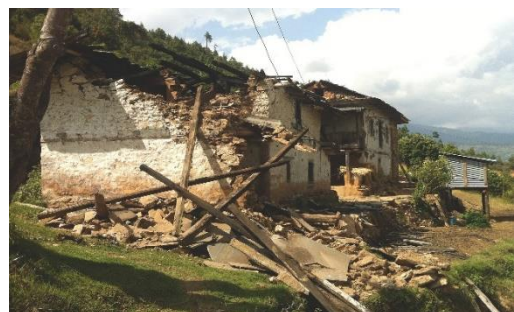
Das zerstörte Kinderhaus in Jiri nach dem zweiten schweren Beben vom 12. Mai 2015
